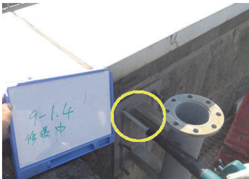
圖 7-12 基礎螺栓第一點未達測試值被拉出-注射化學藥劑
