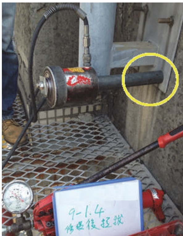
圖 7-18 基礎螺栓第四點未達測試值被拉出-修復後重新拉拔試驗合格
