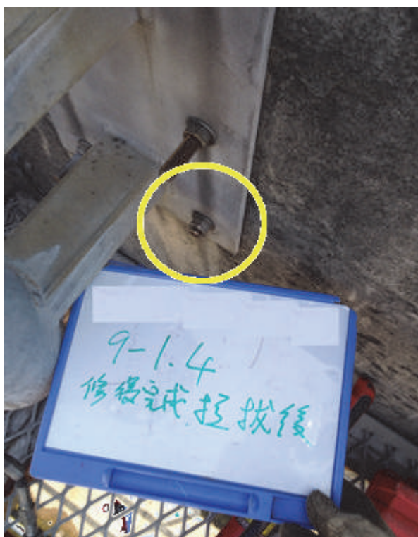
圖 7-19 基礎螺栓第四點未達測試值被拉出-修復後情況
