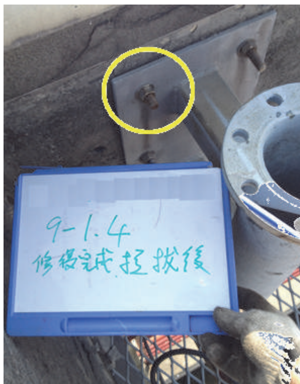
圖 7-14 基礎螺栓第一點未達測試值被拉出-修復後情況
