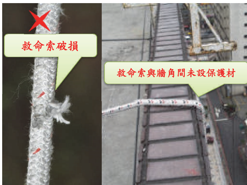
圖 4-75 救命索與牆角間未設保護材，易致救命索斷裂
