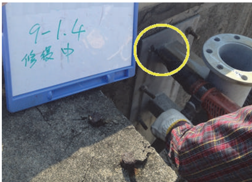
圖 7-11 基礎螺栓第一點未達測試值被拉出-重新鑽孔
