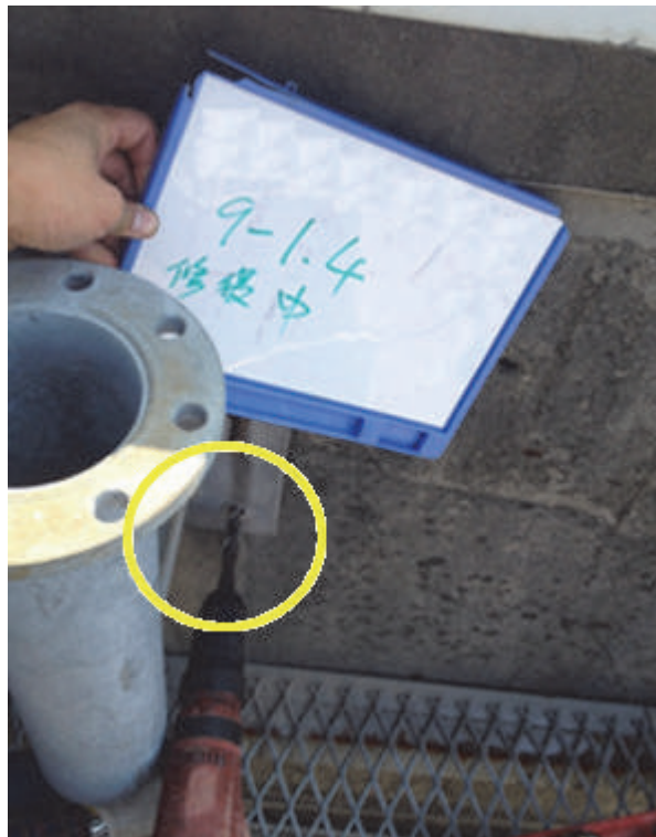
圖 7-16 基礎螺栓第四點未達測試值被拉出-重新鑽孔
