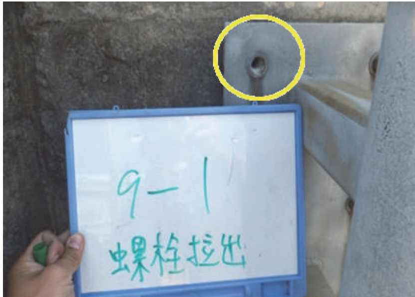
圖 7-10 基礎螺栓第一點未達測試值被拉出
