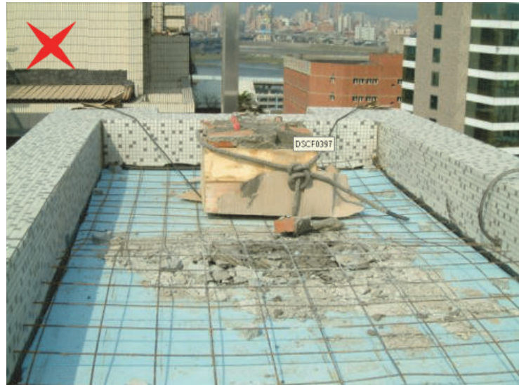
圖 4-25 固定基座未與建築物連接致基座分離破壞情形
