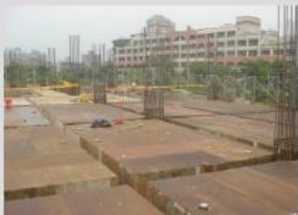
工程常見缺失
