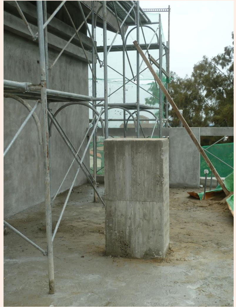
◆ 預留柱未設泛水
