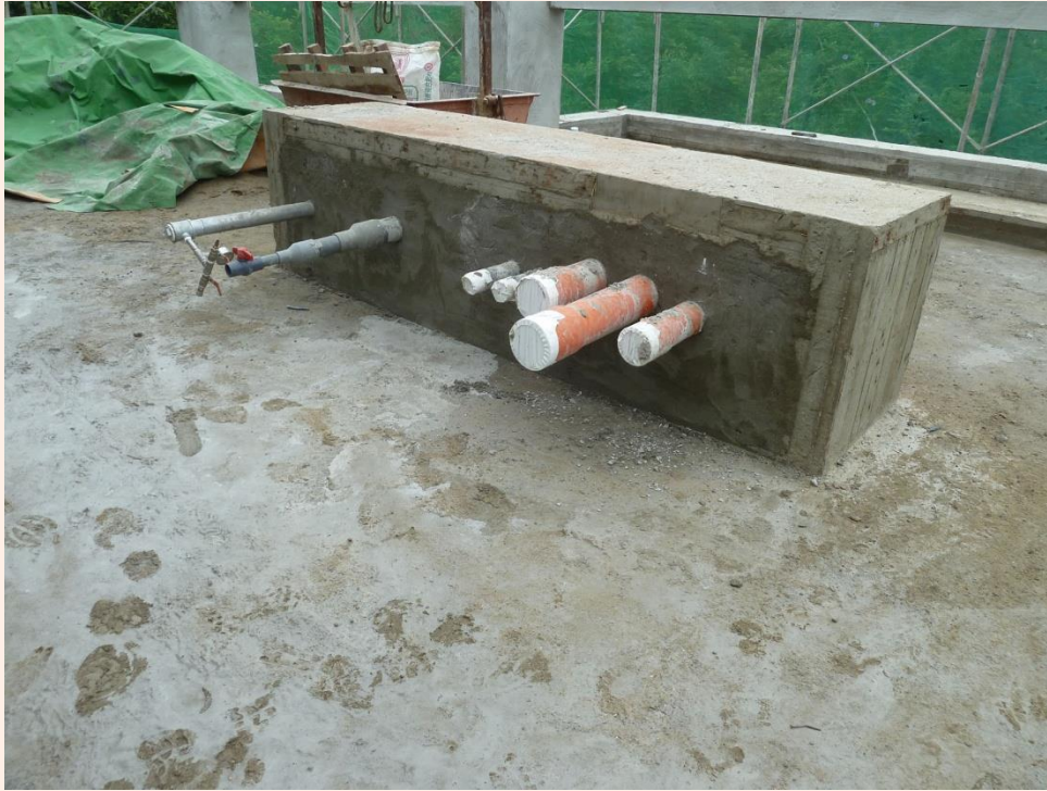
◆ 管道間未設泛水
