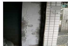
地下室柱爆裂
