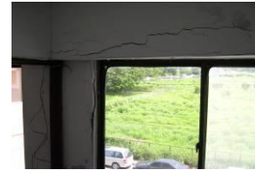
梯廳樑柱龜裂
