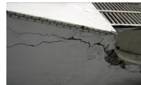
外牆鋼筋外露
