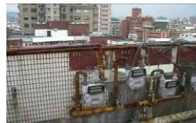
屋頂瓦斯表及管線
