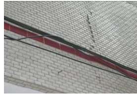
外牆立面龜裂
