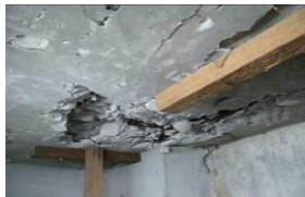
天花板鋼筋外露
