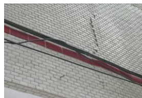
外牆立面龜裂
