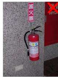
滅火器懸空突出牆壁10公分以上
