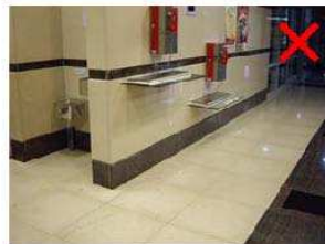
電話突出於通道，且下面未設置防護設施
