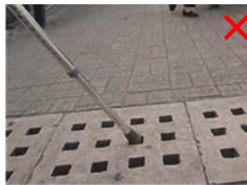
溝蓋開口過大，造成白杖陷入
