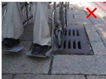
溝蓋開口過大，造成輪椅前輪陷入
