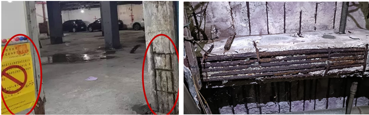
圖七、地下室已張貼黃色危險建物標示
