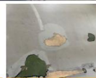
5F~12地板嚴重剝落
