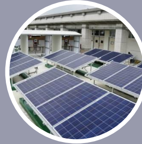
太陽光電 設備
