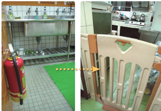
▲ 滅火器放置於廚房，而廚房已用柵欄隔絕
