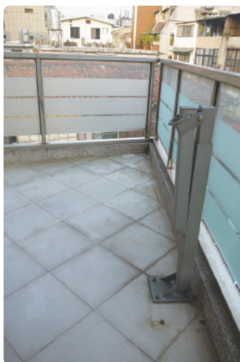
▲ 可供緊急逃生之陽台
