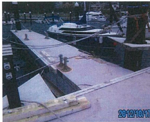
三角框螺栓斷裂
