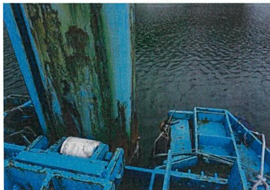
滾輪導版脫落
