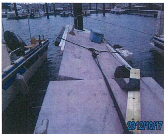
浮箱體破損傾斜
