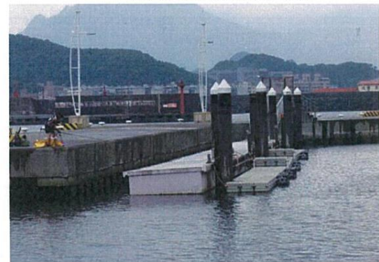
主走道浮箱呈現傾斜
