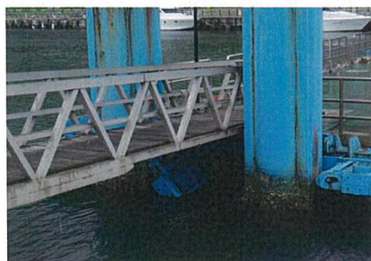
導框架及滾輪脫落
