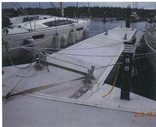
三角框螺栓斷裂浮箱受損
