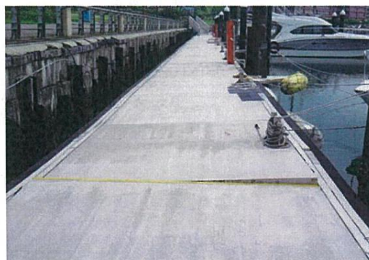
主走道浮箱銜接處高低落差
